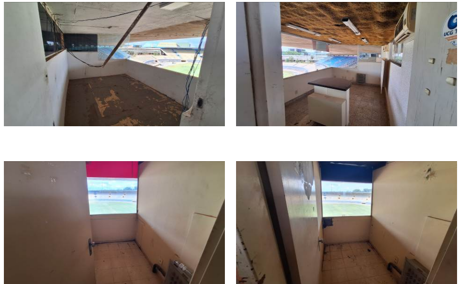
Vista das instalações das cabines de rádio/TV
