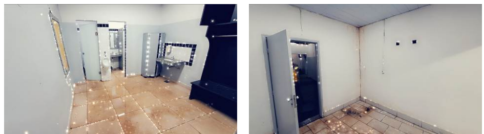
Detalhe das infiltrações na sala de antidoping
