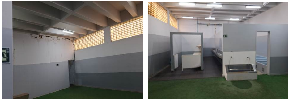
Vista das instalações do vestiário 1 com detalhe da infiltração
