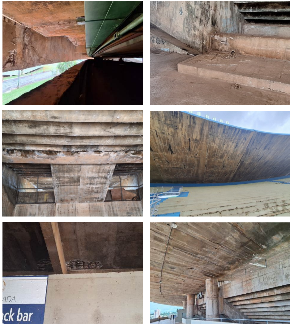
Detalhe de danos típicos em elementos de concreto
