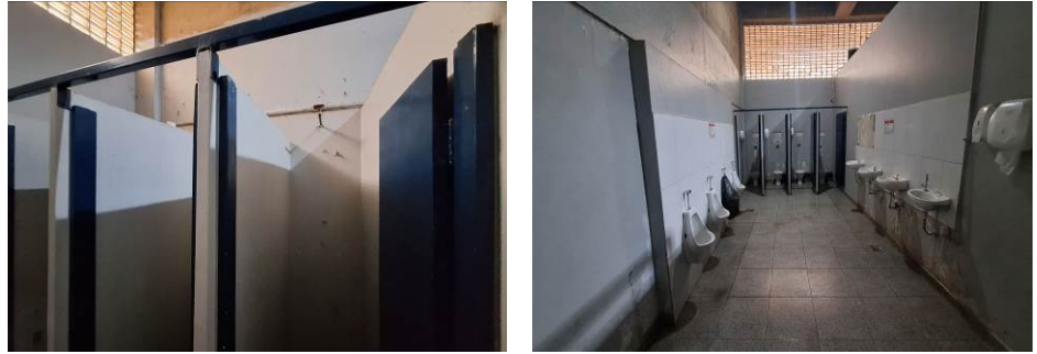
Detalhe de chuveiro faltando e instalações elétricas do banheiro feminino e detalhe dos revestimentos do banheiro masculino
