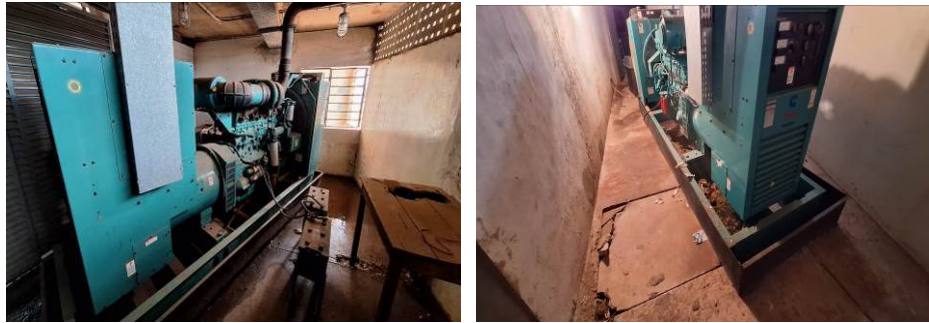
Vista dos geradores do nível térreo e superior
