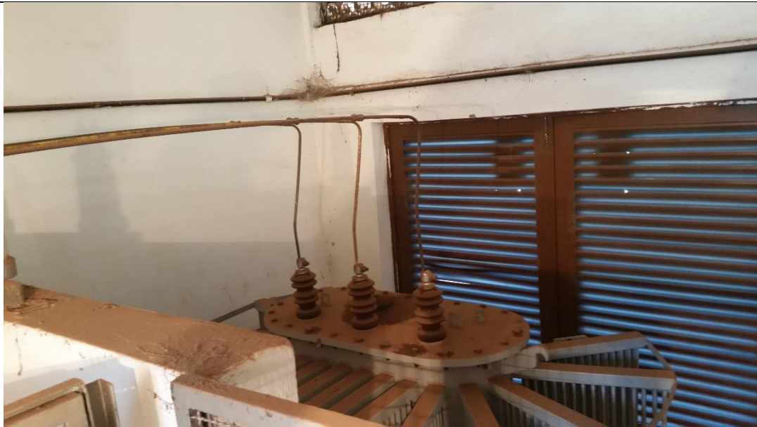
Tranformador com óleo isolante – 500 kVA Vista Superior
