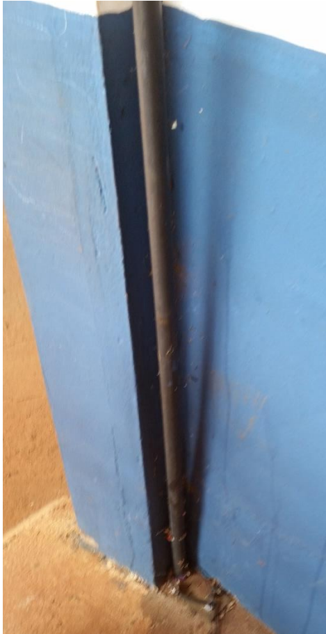
Eletroduto sem fixação. Transição para eletroduto subterrâneo sem caixa de passagem.
