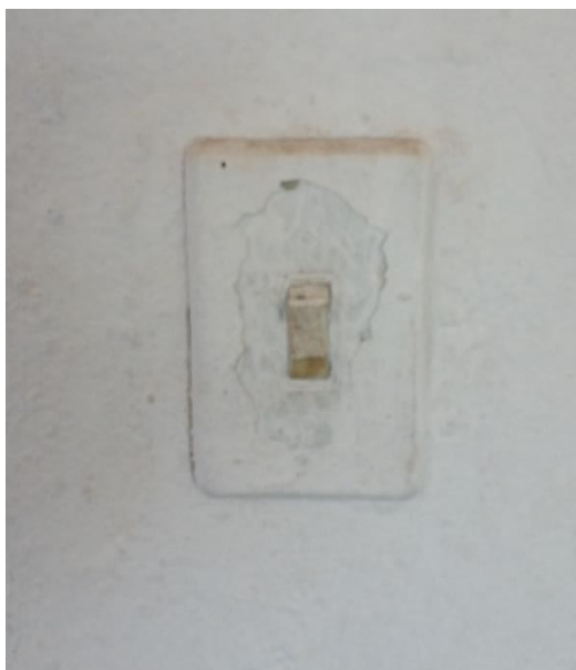
Interruptor coberto de tinta. – Sala da imprensa
