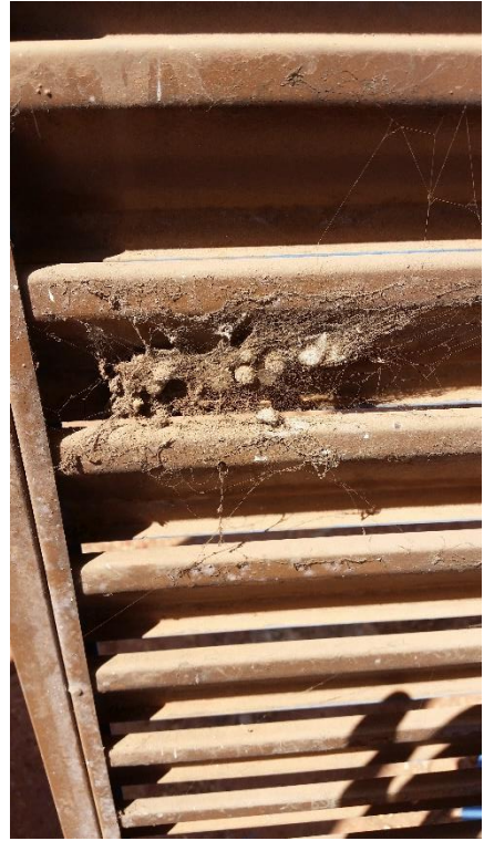
Parte interna – Porta – Cabine Torre 06
