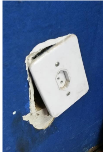
Caixa de tomada mal fixada
