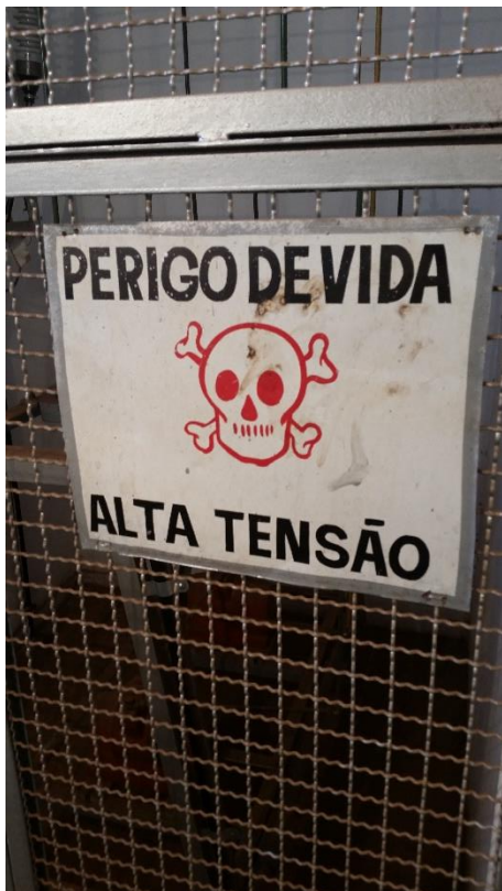
Placa de advertência
