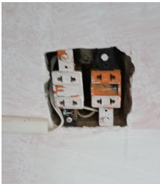
Padrão antigo de tomada. Tomada embutida alimentada por fiação em eletroduto sobreposta. Sala de imprensa..
