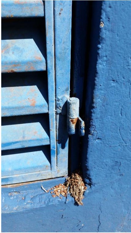
Dobradiça quebrada – Cabine Torre 06
