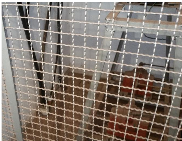
Entrada subterrânea de MT, Cavalete Metálico
