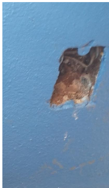
Caixa de passagem sem tampa – Sala da imprensa.
