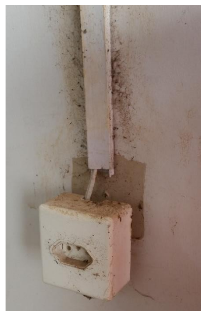
Caixa de tomada solta. Tomada e canaleta sujas.
