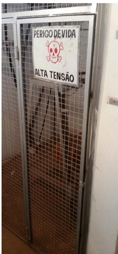
Grade com placa de advertência
