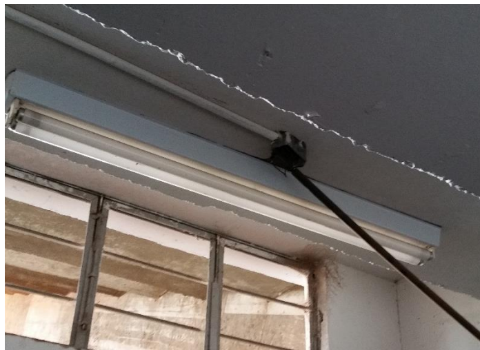
Eletroduto não fixado. Conexão incorreta com o condutele.
