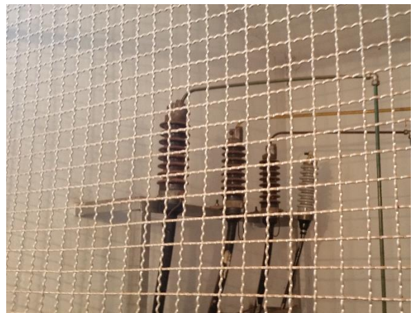
Muflas Internas, Barramento de MT
