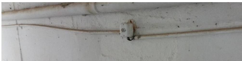
Eletroduto quebrado e sem fixação. – Vestiário.
