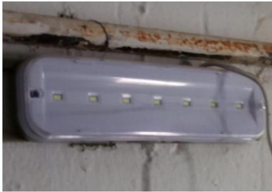
Bloco autônomo de emergência – Vestiário.
