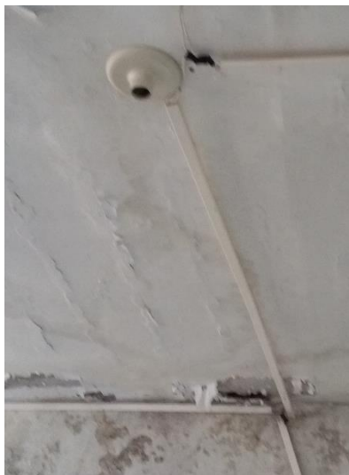
Canelata quebrada. Curva em canaleta sem derivação
