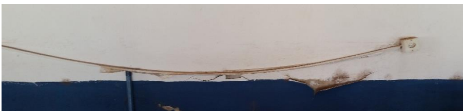
Canaleta deformada - Corredor/ Juizado
