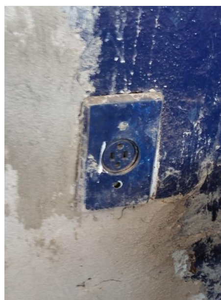
Tomada padrão antigo e coberta de tinta.
