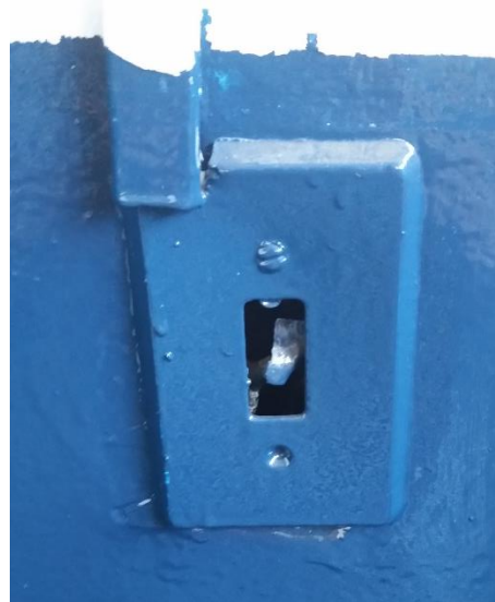
Tampa de interruptor cortada. Canaleta de sobrepor para caixa embutida. Interruptor sem tecla. Vestiário.
