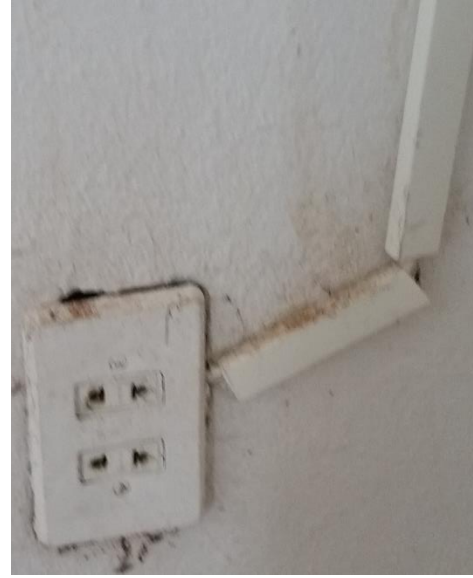
Curva 90° em canaleta s/caixa de derivação
