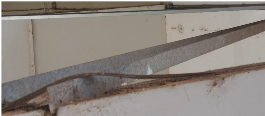
Eletrocalha sem tampa. Cabo fora da eletrocalha - Corredor/ Juizado
