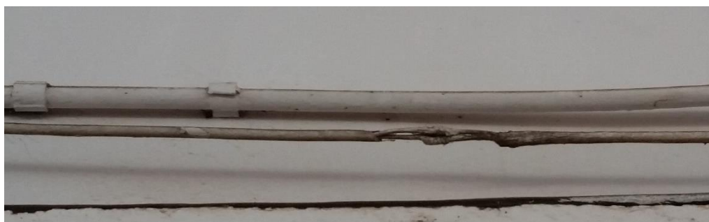
Condutor com capa de isolamento externa danificada.
