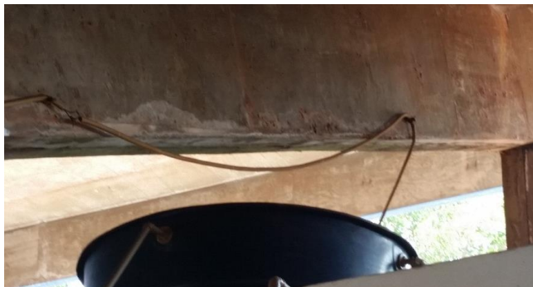
Eletroduto totalmente quebrado, dobrado e sem fixação.
