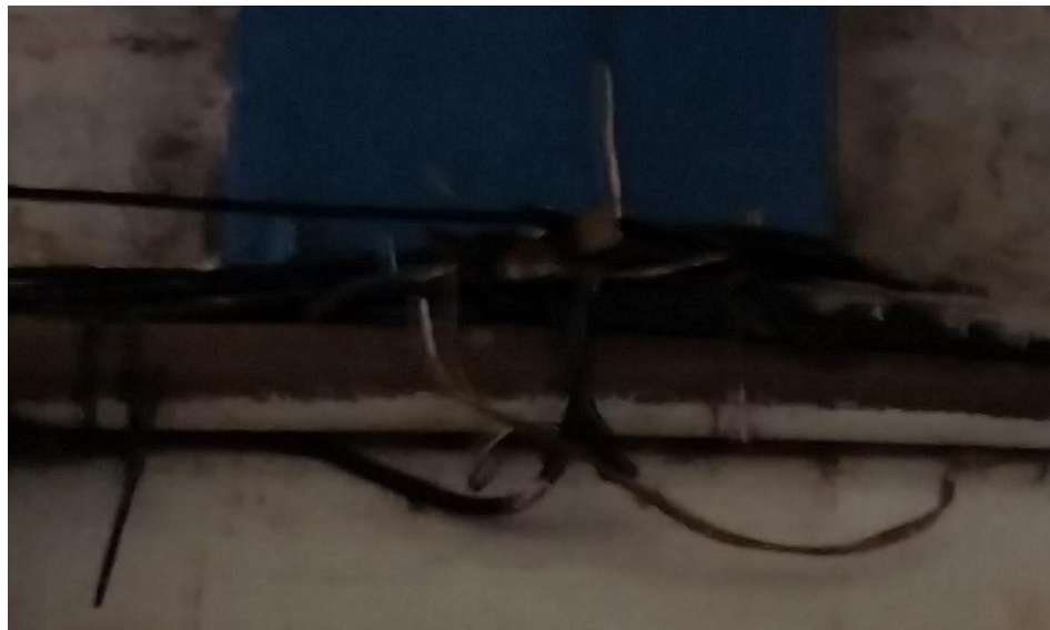
Derivações inadequadas nos cabos (“gambiarra”). Cabos fixados com arame e sujeitos a serem danificados
