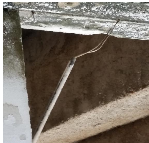
Eletroduto quebrado e não fixado..
