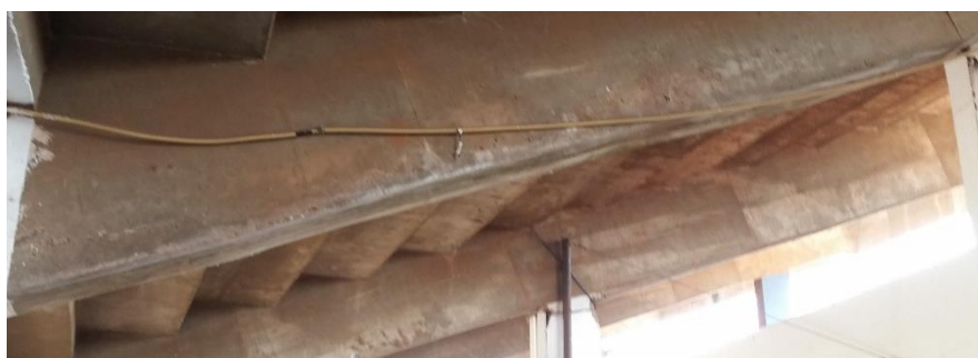
Eletroduto quebrado e sem fixação.
