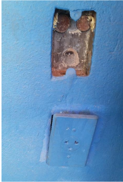
Padrão de tomada antigo. Tomada pintada. Caixa de passagem sem tampa – Sala da imprensa.-
