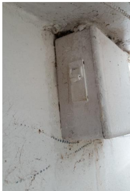
Caixa com disjuntor
