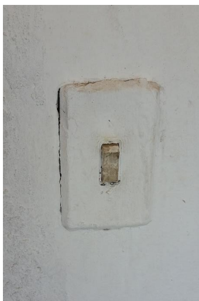
Interruptor coberto de tinta.
