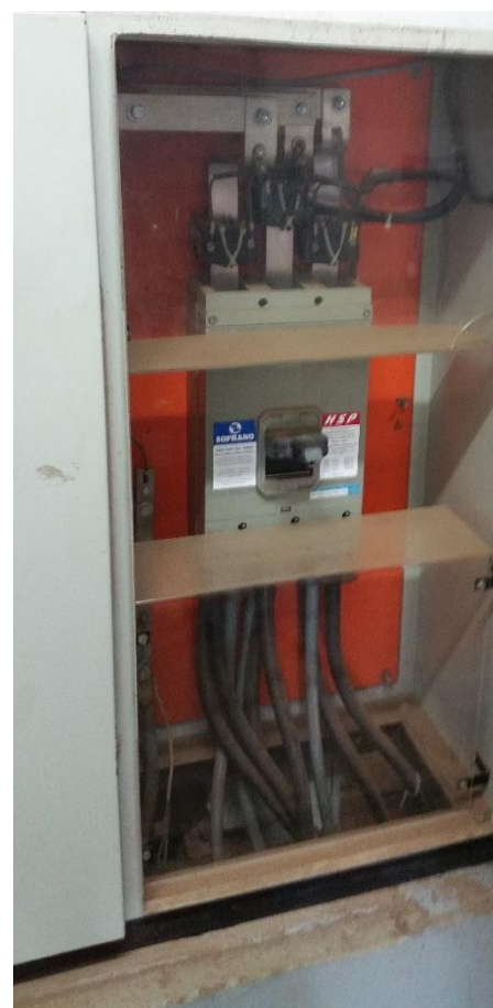
Disjuntor de Proteção – QDL-Campo
