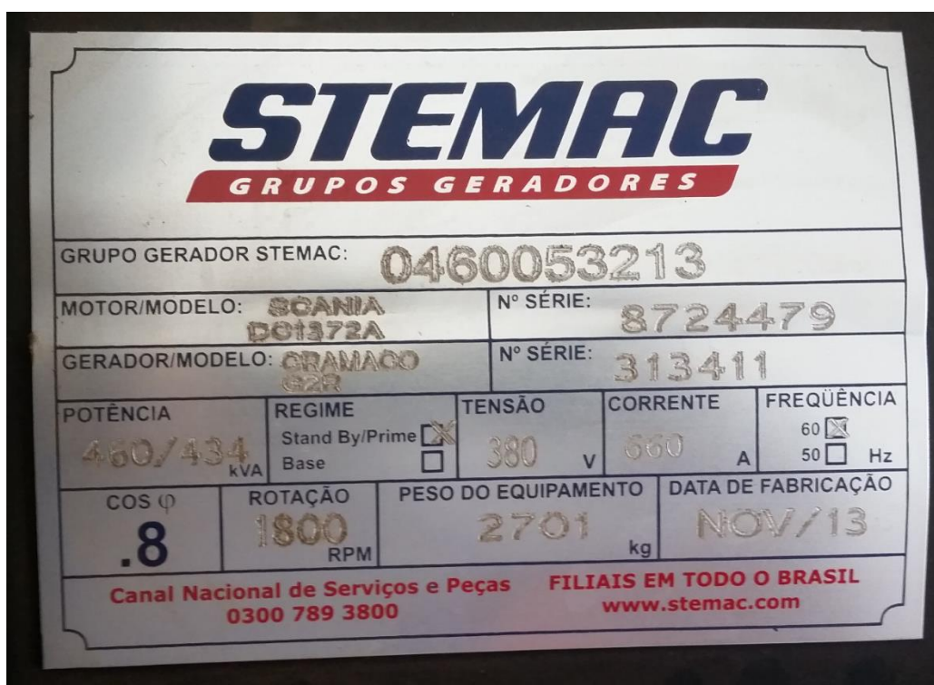
Placa de Identificação do grupo Moto-Gerador.
