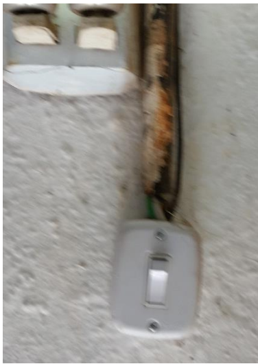
Interruptor para canaleta conectado em eletroduto. Vestiário.
