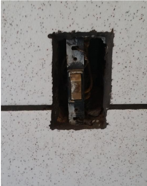
Interrupor sem tampa. – Sala de imprensa.
