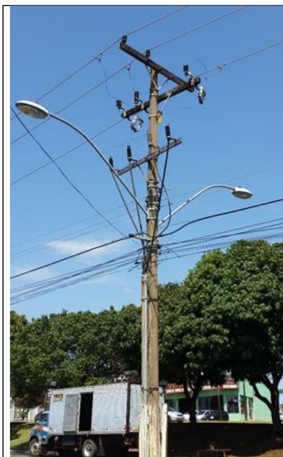
Poste de Entrada – MT
