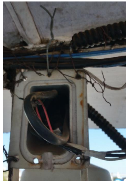
Caixa de passagem (câmara) sem tampa. Cabos amarrados por arame. - Corredor de acesso à Sala de Imprensa.
