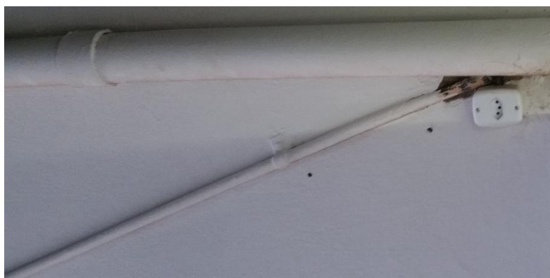
Transição do eletroduto embutido para eletroduto aparente sem derivação adequada – Vestiário.
