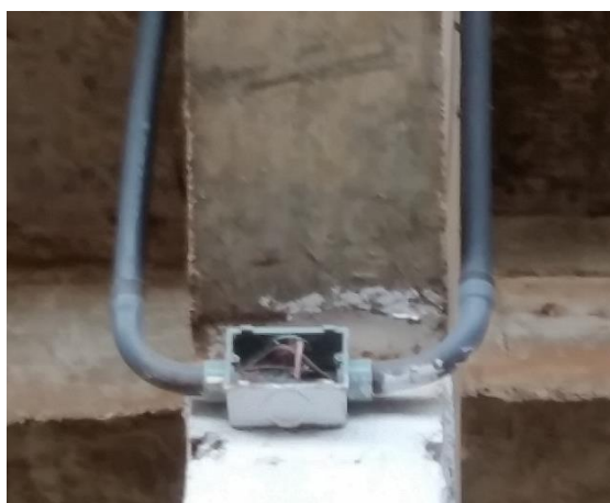
Condutele sem tampa.
