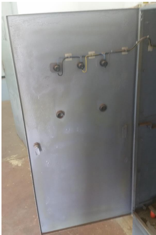
QGBT – Porta – Parte interna
