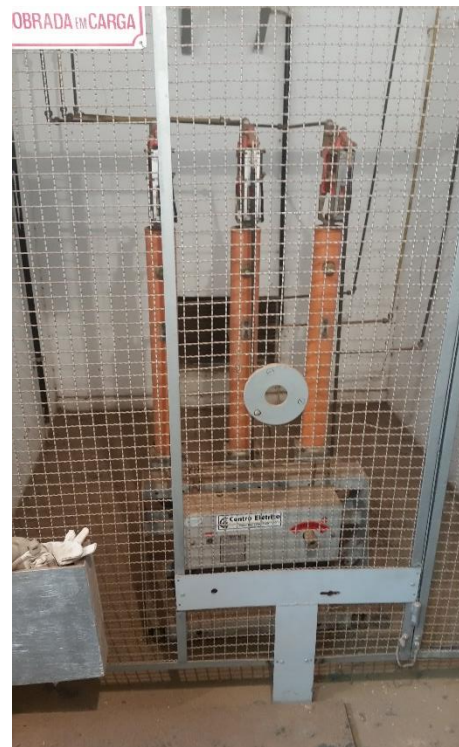
Disjuntor de Média Tensão.
