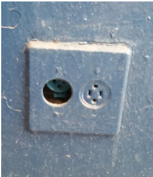
Tomada padrão antigo. Tomada mal encaixada e coberta de tinta. - Sala da imprensa.
