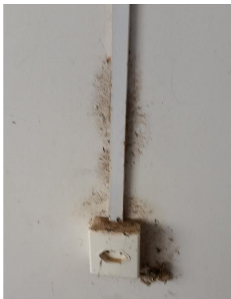
Canaleta e caixa p/tomadas sujas.
