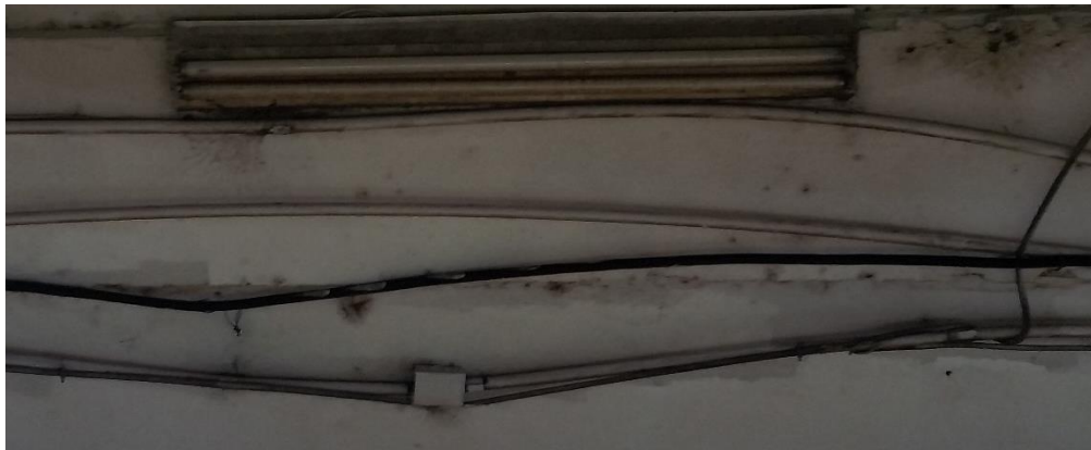
Eletroduto quebrado e fixado com arame.
