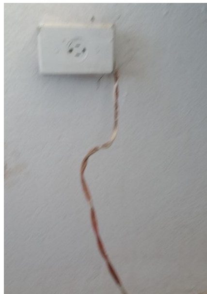
Tomada padrão antigo. Condutor solto. Sala de imprensa.
