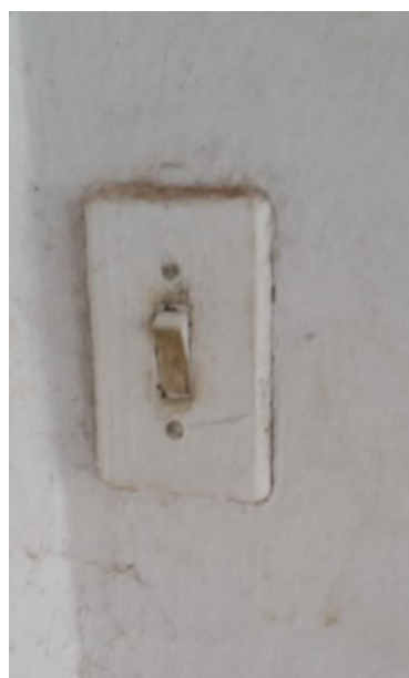
Interrupor coberto por tinta.
