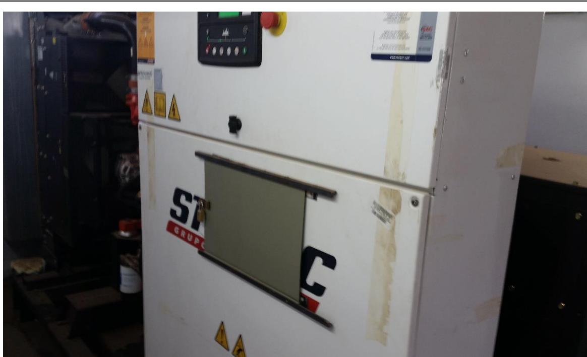
QTA com tampa original alterada
