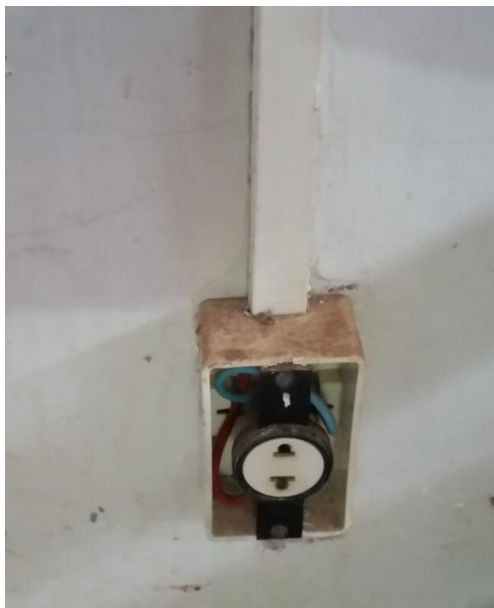
Padrão antigo de tomada. Tomada sem tampa. Caixa de tomada suja. - Sala de imprensa.
