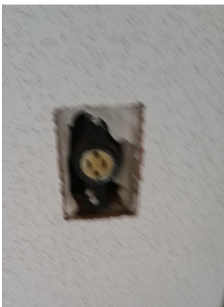
Tomada – Padrão Antigo e sem tampa.
