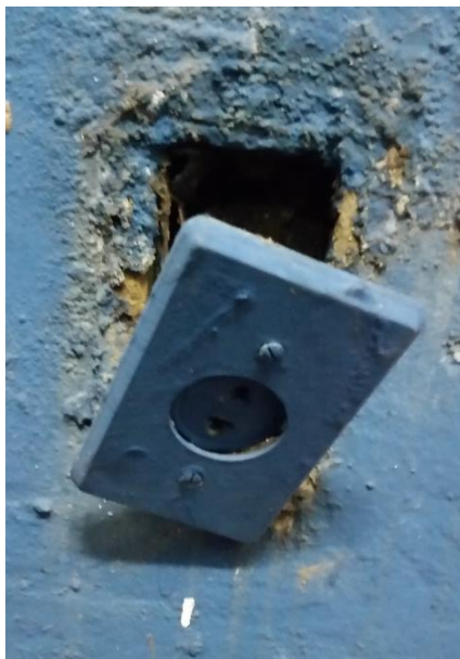
Padrão antigo de tomada. Tomada solta. Sala de imprensa.
