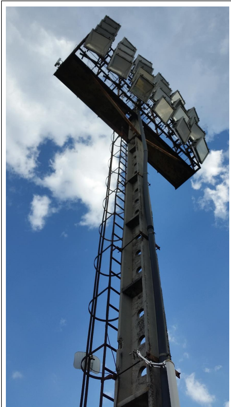
Torre – Eletroduto não adequado ao ambiente externo.
