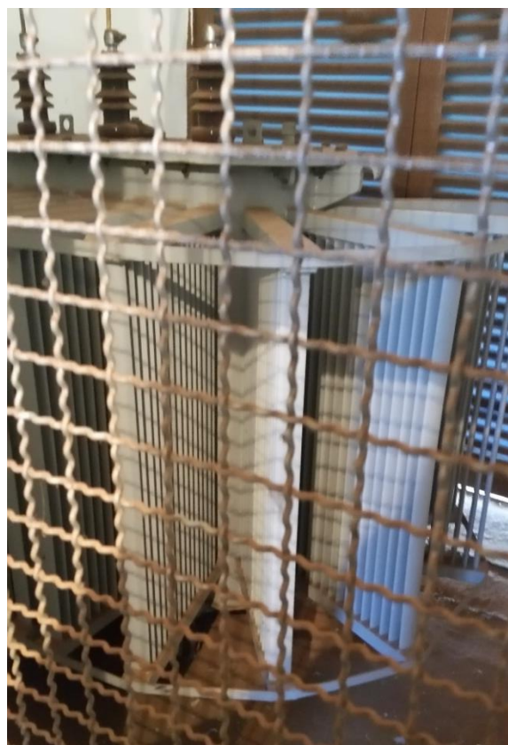
Tranformador com óleo isolante – 500 kVA Vista Frontal
