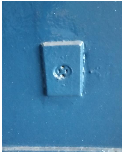
Tomada padrão antigo e coberta de tinta. Vestiário.
