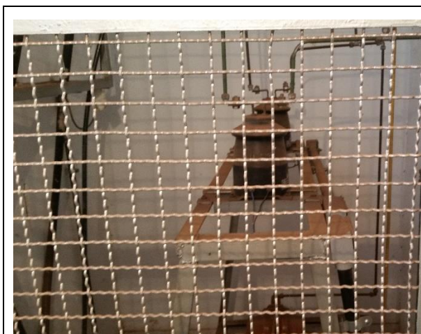
Transformador de Corrente
