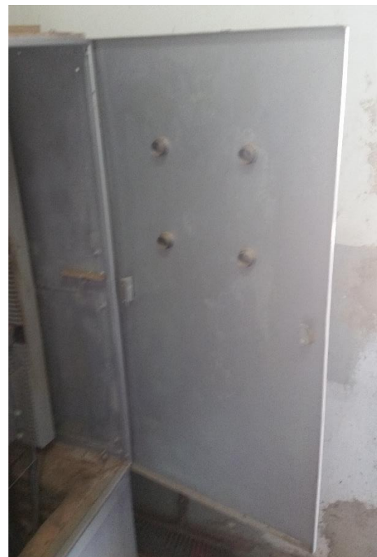
QGBT – Porta – Parte interna
