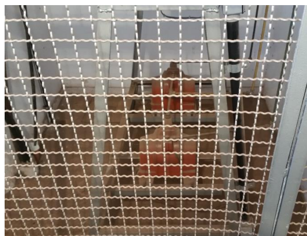
Transformador de Potencial
