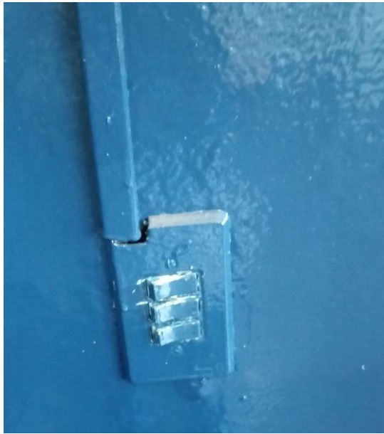
Tampa de interruptor cortada. Interruptor coberto de tinta e teclas presas. Canaleta de sobrepor para caixa embutida. – Vestiário..
