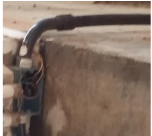
Derivação inadequada da fiação.
