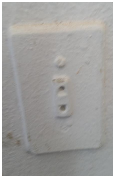
Padrão antigo de tomada. Tomada coberta de tinta. - Sala de imprensa..
