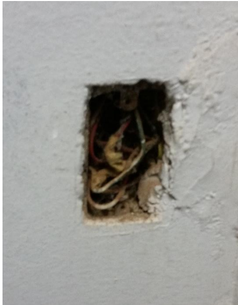
Caixa de passagem sem tampa. Emenda da fiação com fita não isolante.
