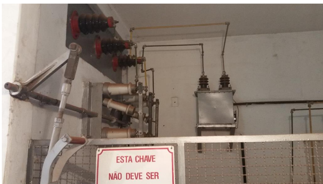
Muflas, Bucha e Transformador de Potencial, Placa de Advertência
