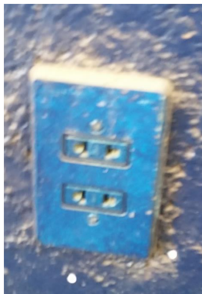
Padrão antigo de interruptor. Interruptor coberto de tinta.
