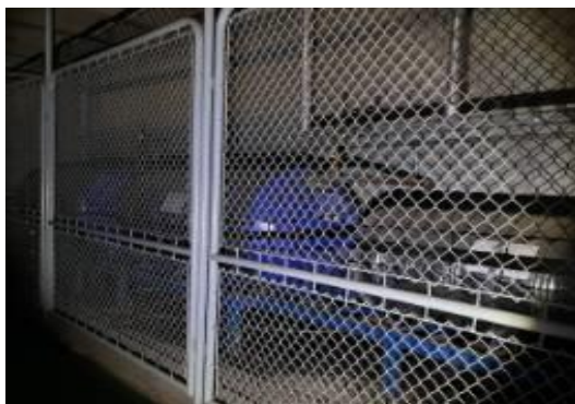
Vista dos boilers
