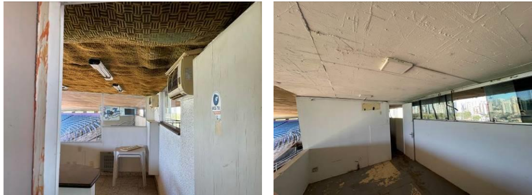
Vista das instalações das cabines de rádio/TV
