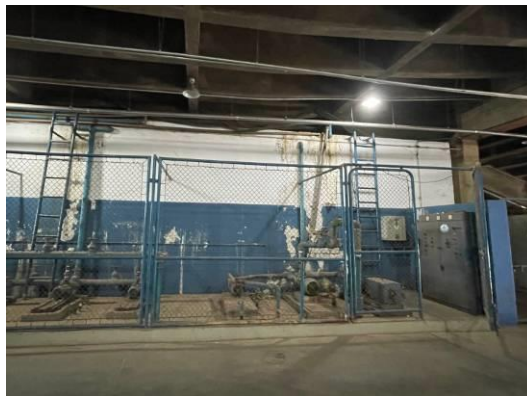
Vista das motobombas
