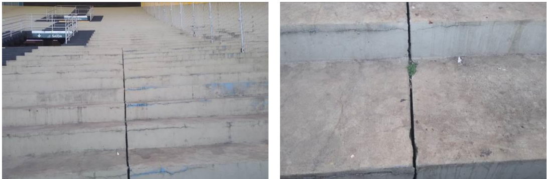
Detalhe das fissuras e esborcinamento das juntas das arquibancadas
