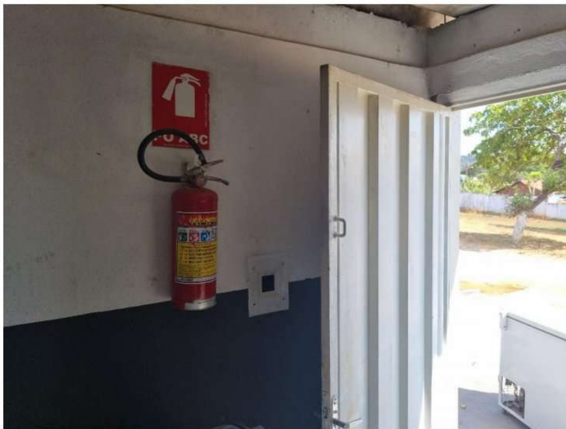
Foto 27: Extintor de incêndio
