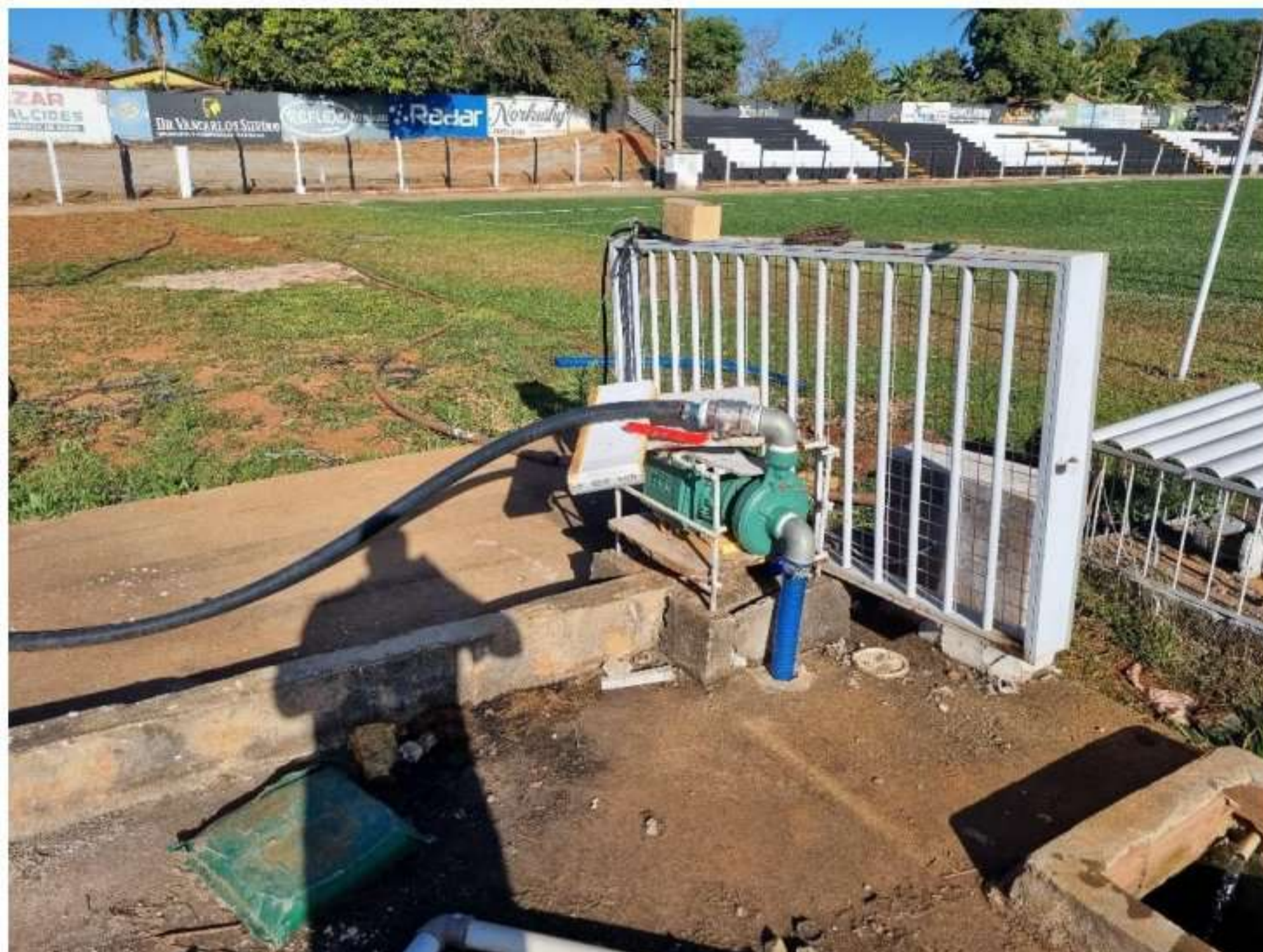
FOTO: Sistema de Instalações Hidrossanitárias
