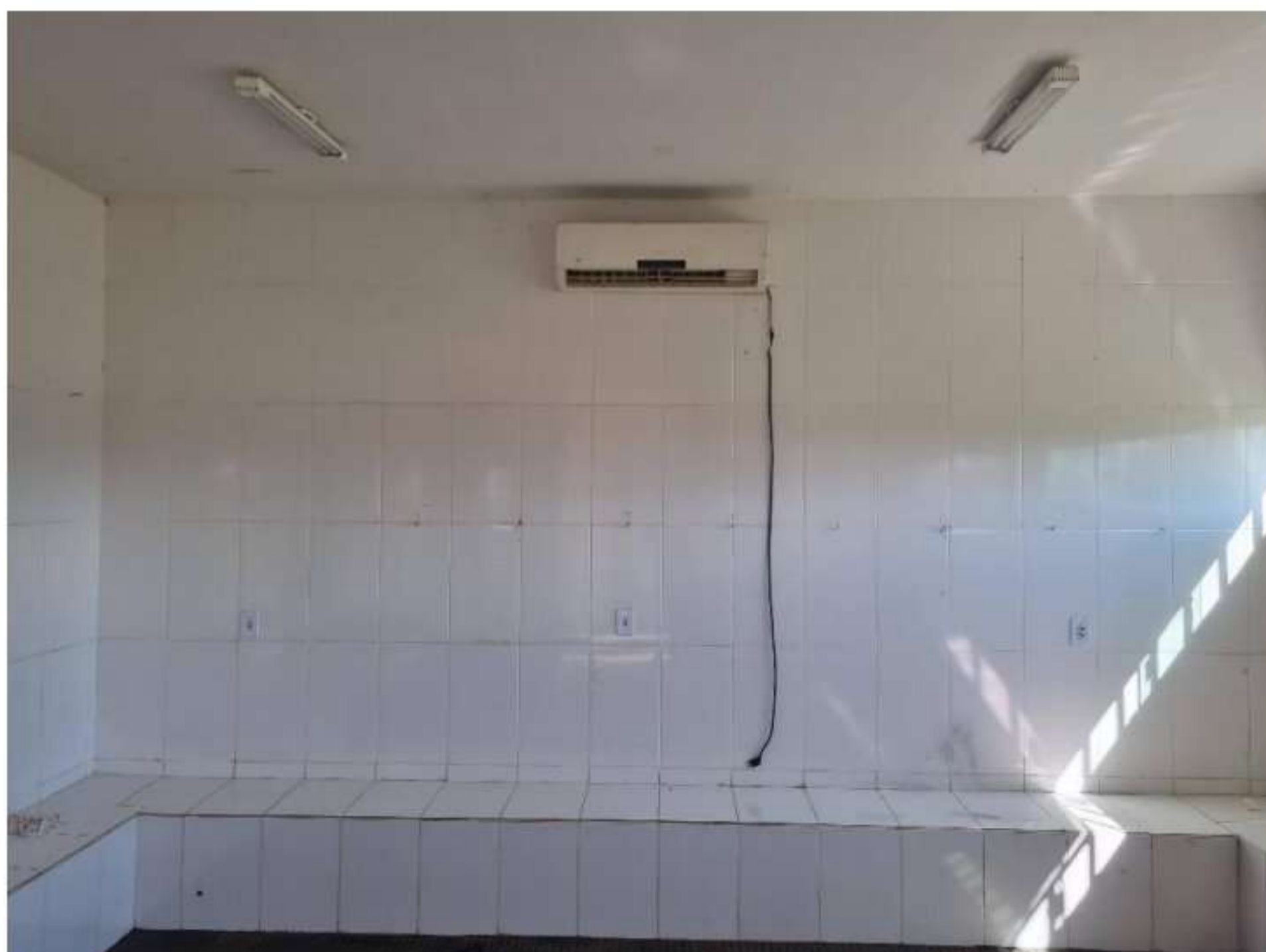
Foto 26: Ar condicionado do vestiário
