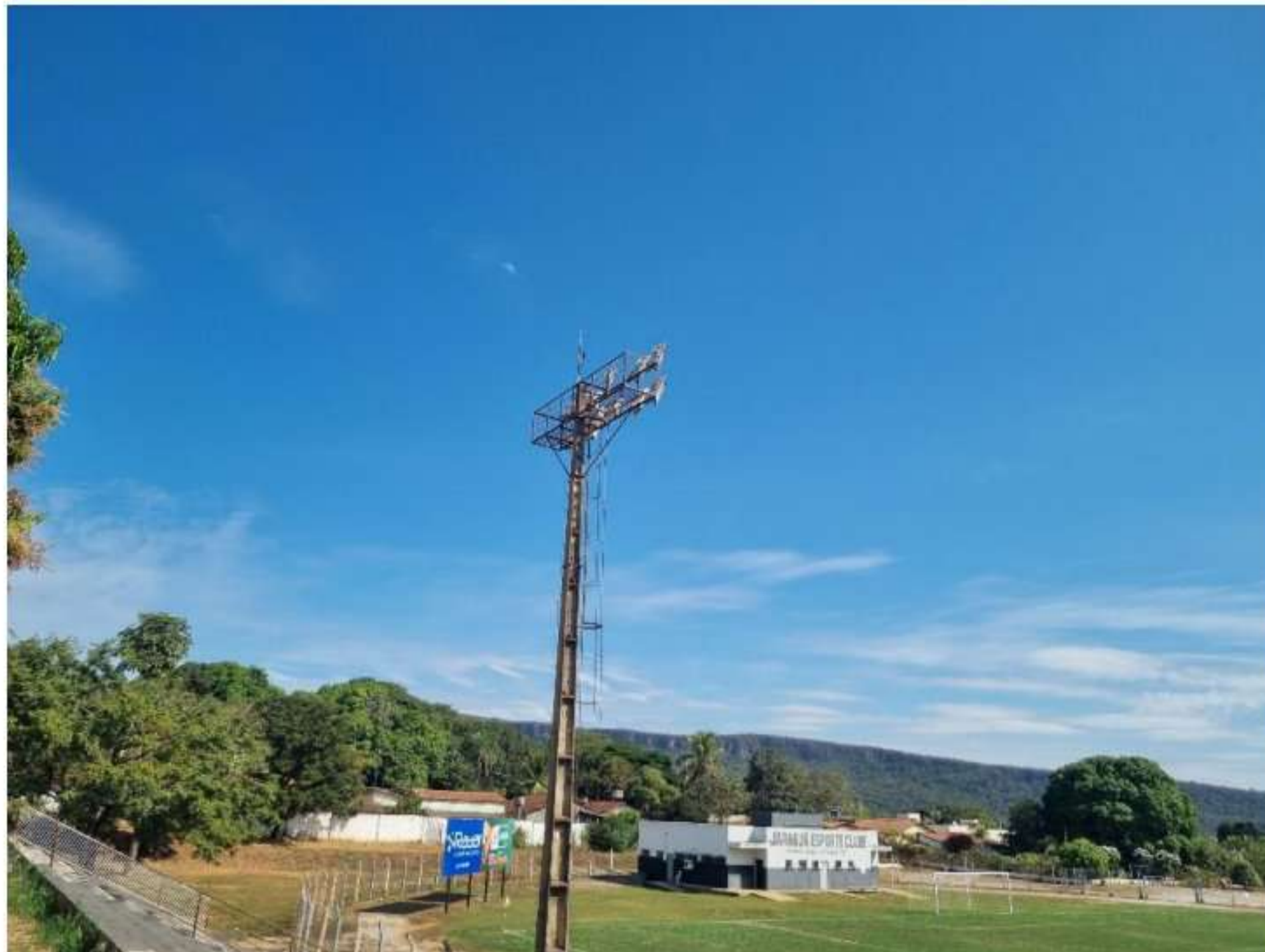
Foto 28: Torre de iluminação
