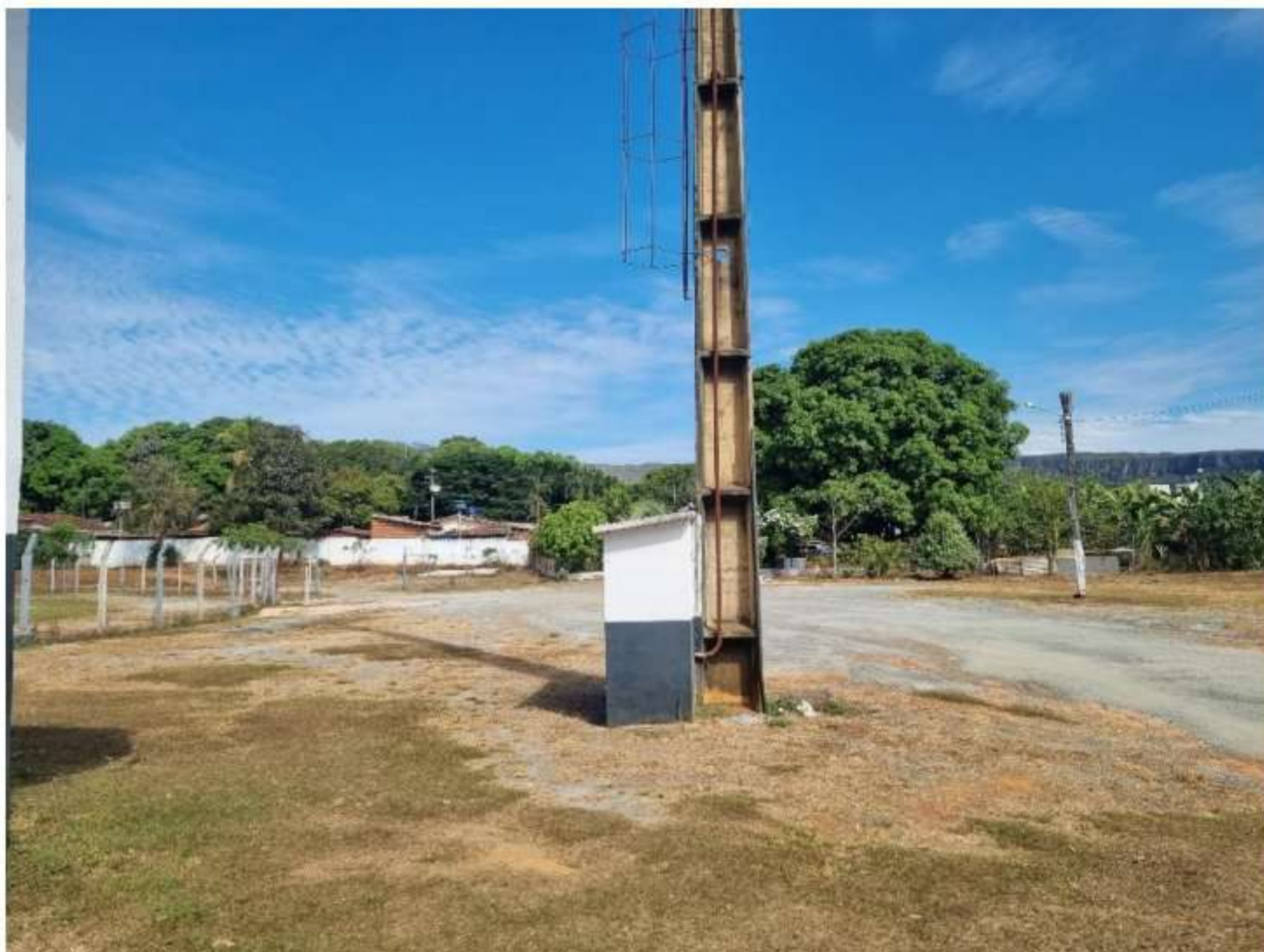
FOTO: Sistema de Instalações Elétricas
