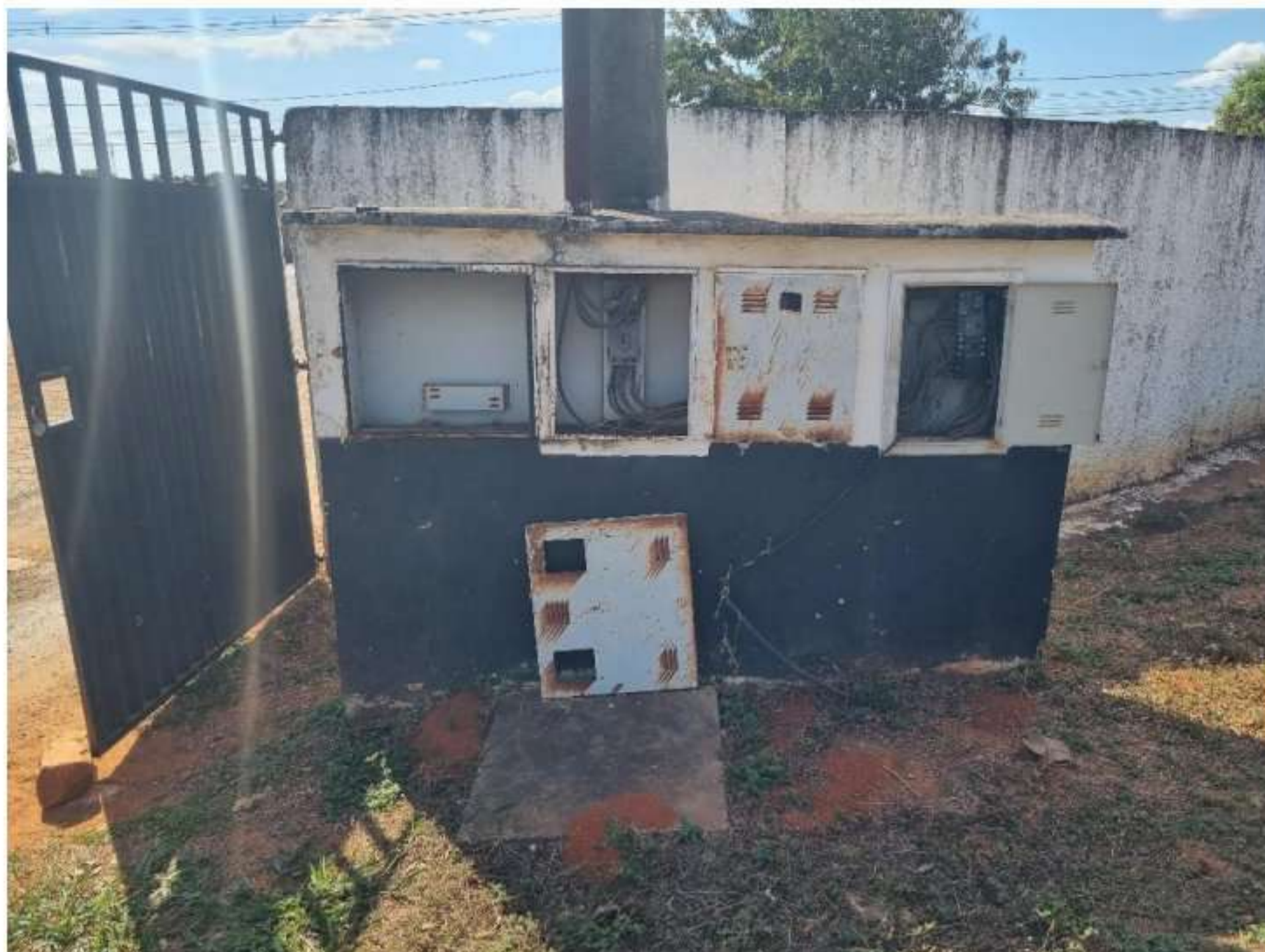
Foto 29: Quadro de distribuição
